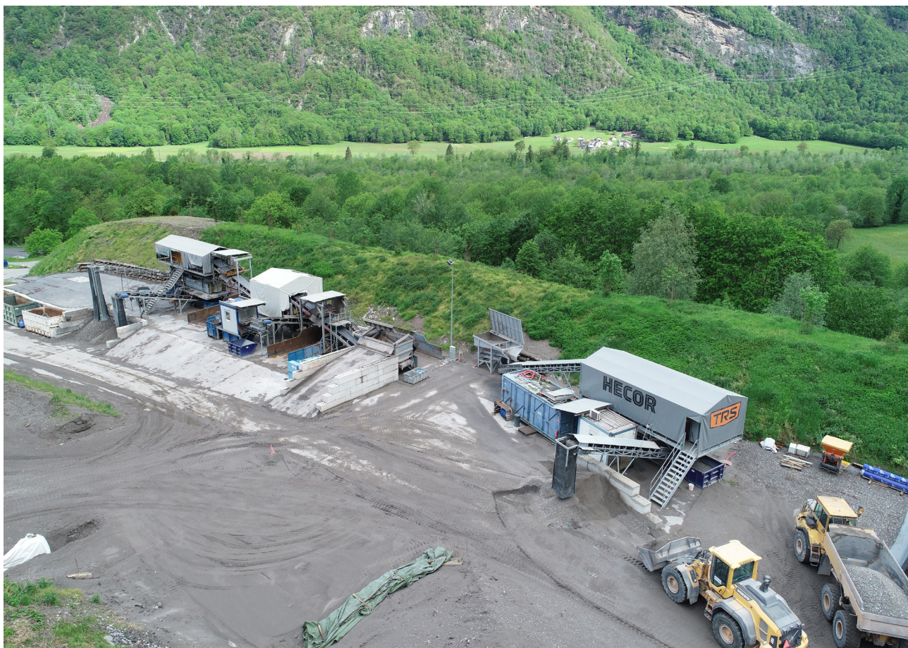
Figura 6 Impianto di vagliatura.
