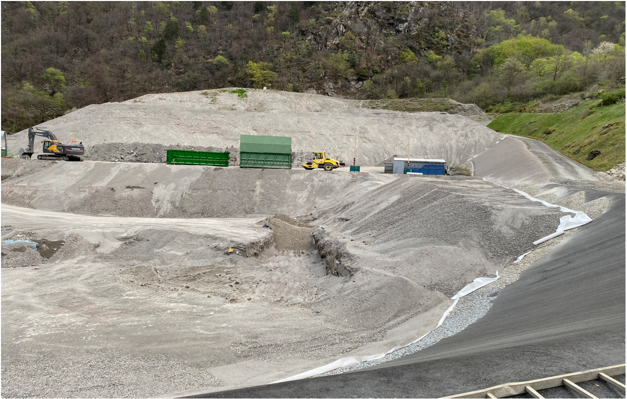
Figura 3 Vista della discarica, sul retro tappa IV e in primo piano tappa V (CRER, 2023).
