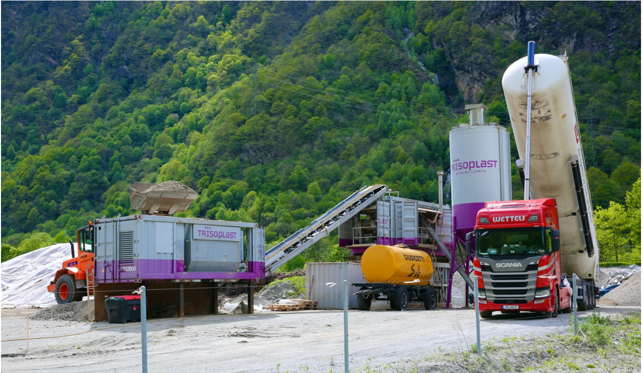
Fase di carico a Cabbio del miscelatore della ditta olandese Trisoplast con polimeri sintetici e betonite importati direttamente dall'Olanda e sabbia speciale proveniente dal Canton Ticino
