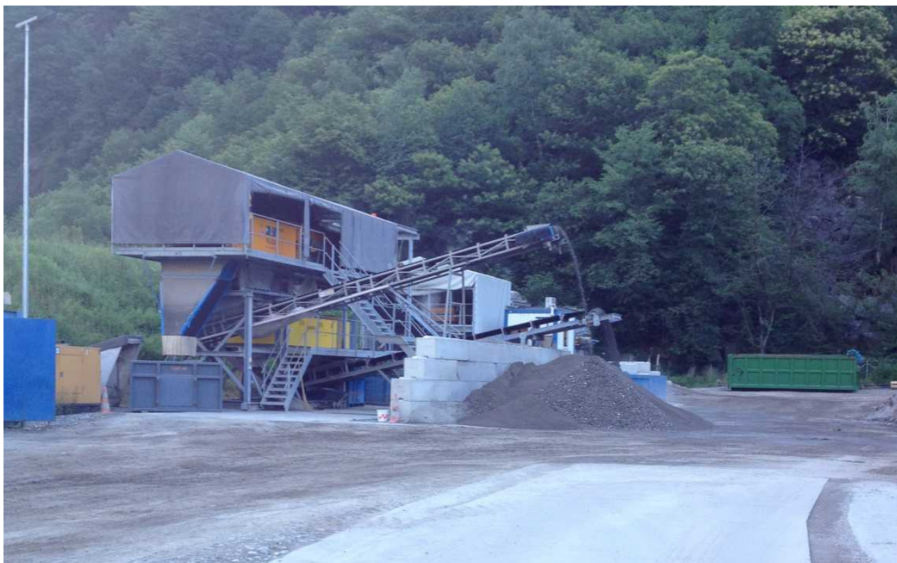
Figura 4 Impianto di vagliatura.
